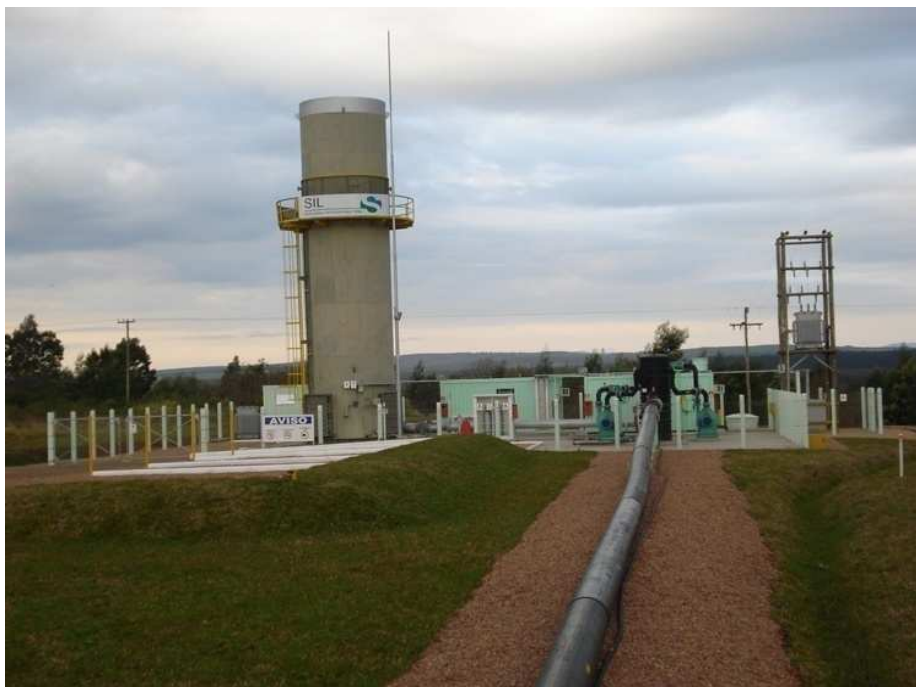
Figura 44 - Sistema de queima de gases.
